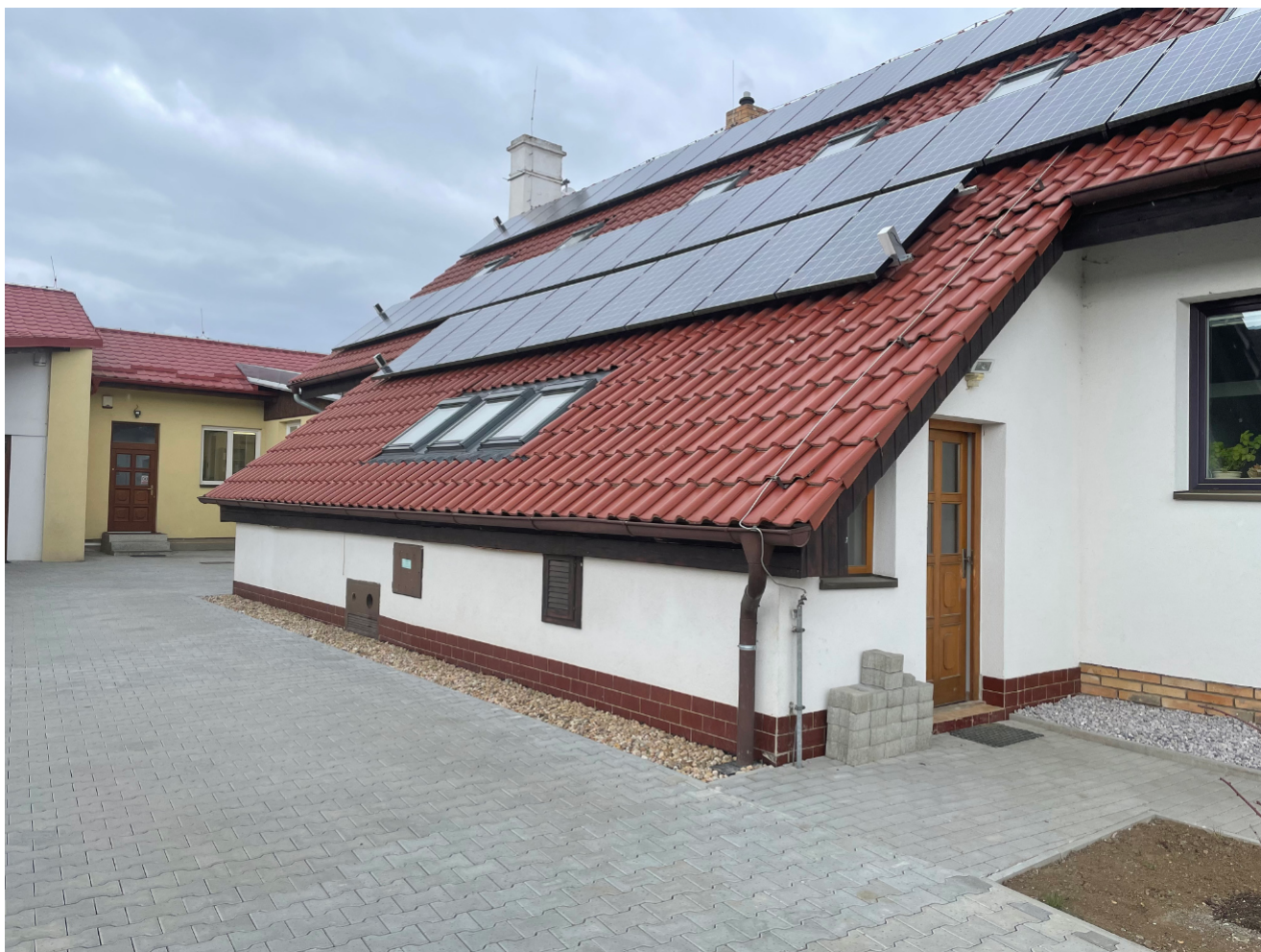
Fotovoltaická elektrárna na střeše provozovny v Dřetovicích
