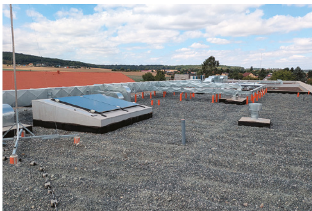
Střešní kořenová čistírna odpadních vod před osázením rostlinami.
