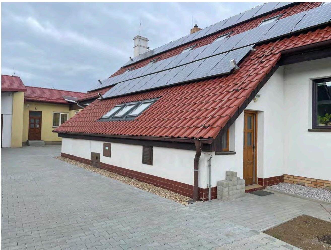
Fotovoltaická elektrárna na střeše provozovny v Dřetovicích
